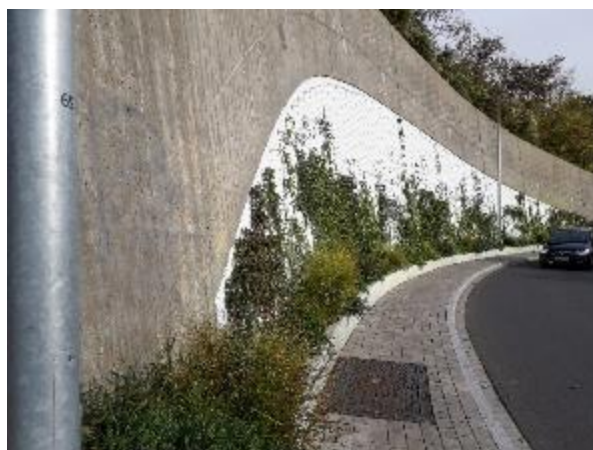
Bild 12: Bei der Begrünung von Straßenbauwerken wie dieser über 10 m hohen Stützwand ist noch Luft nach oben: Die Stahlseile hätten durchaus noch weiter reichen können – warum hat man sich an die Mauergeometrie gehalten?
